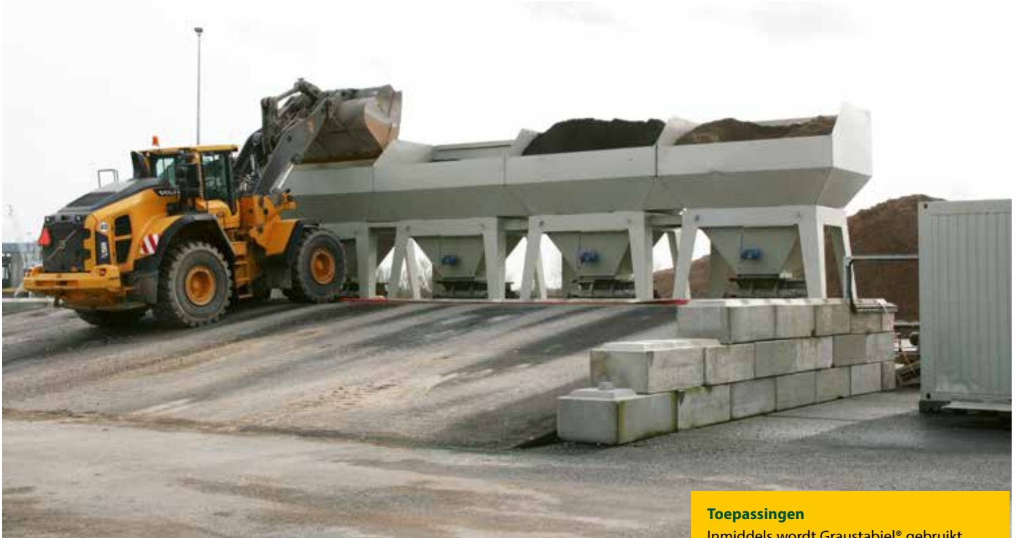
De menginstallatie in Dodewaard. De componenten worden op een transportband gedoseerd, in de mengtrommel op het juiste vochtpercentage gebracht en vervolgens met de transportband op de laadlocatie gestort.
