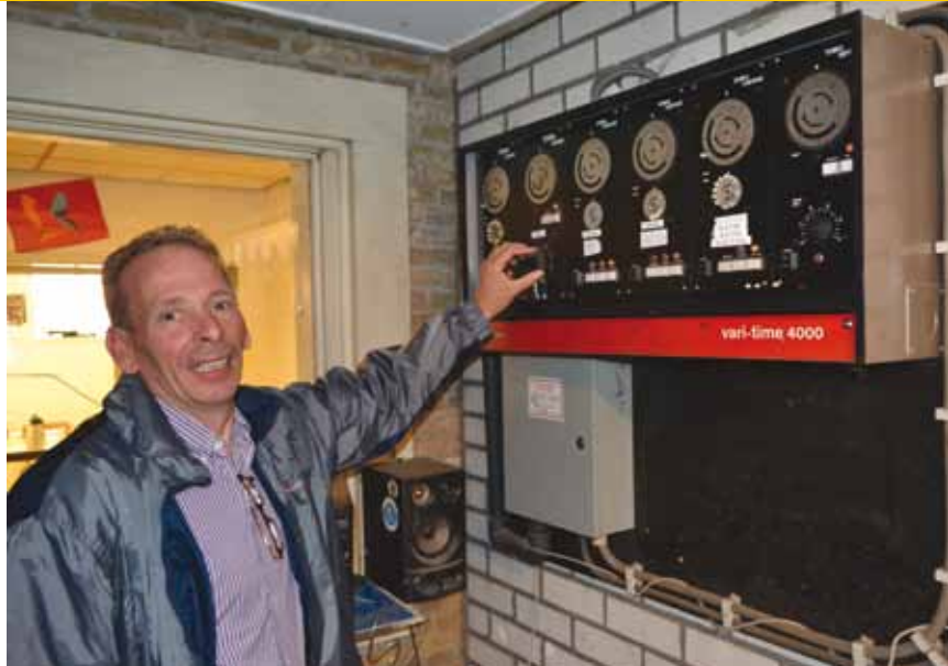
Ook de oude hoofdschakelkast, waar Schoot Uiterkamp naast staat, is inmiddels verdwenen. Een pc heeft de functie hiervan overgenomen.
