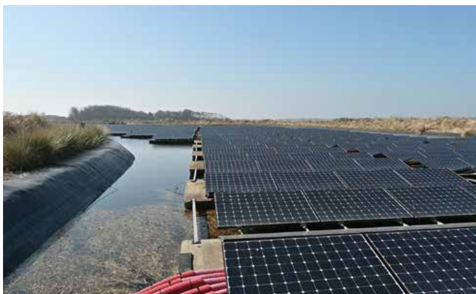
Waterbassin met 2400 zonnepanelen
