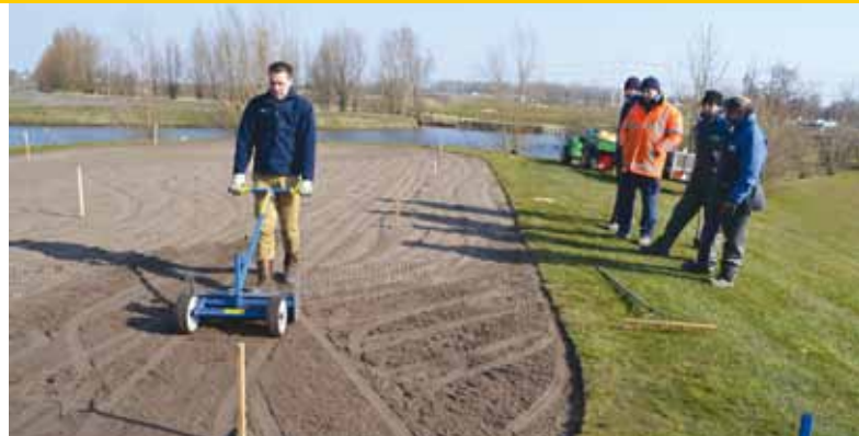
Werken met piketten en maatstreek. Je kunt ook referenties op de juiste hoogte kunnen uitmeten met de laser, zoals stratenmakers doen.
